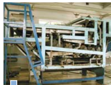
Fot. 2. Prasa taśmowa TPF [Biowogaz]
