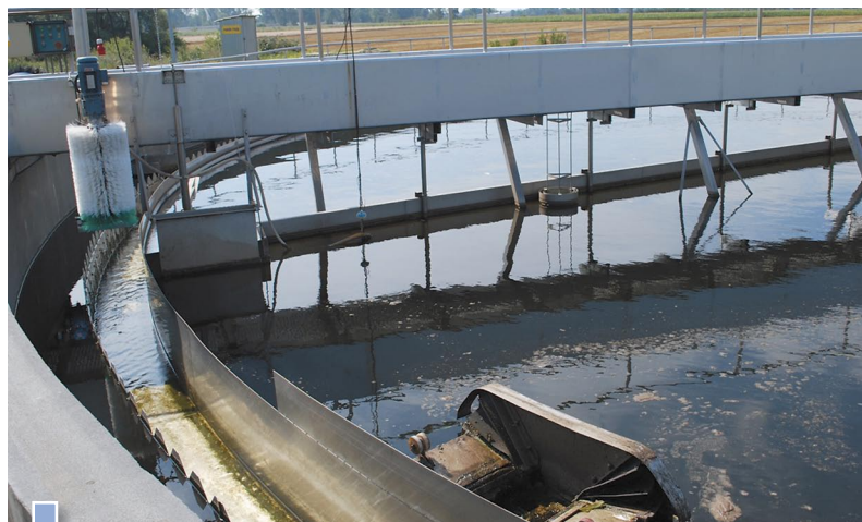
Fot. 3. Osadnik wtórny radialny o przepływie pionowym z przelewem pilastym pojedynczym oraz lejem zbierającym wyfotowany na powierzchni osad czynny
