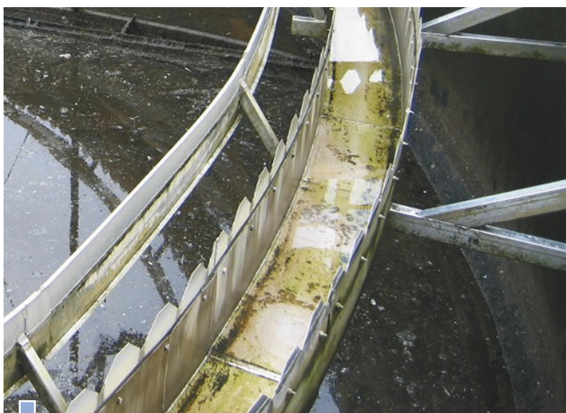
Fot. 5. Przelew pilasty dwustronny z deską deflektorową osadnika wtórnego pionowego
