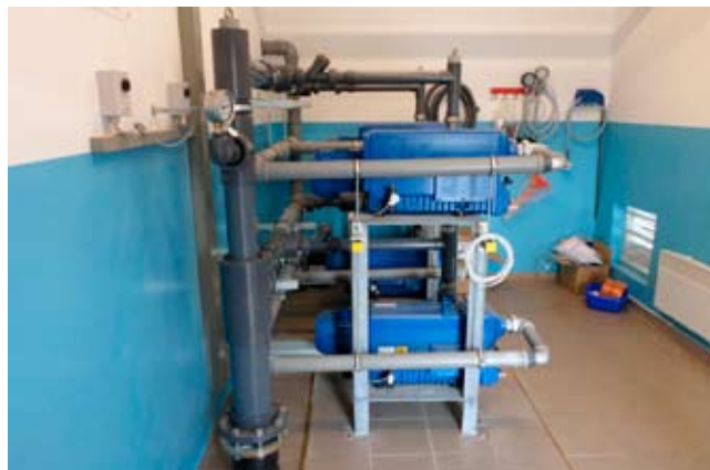
Rys. 5. Wnętrze stacji podciśnieniowej w Raczycach (zdj. własne)
